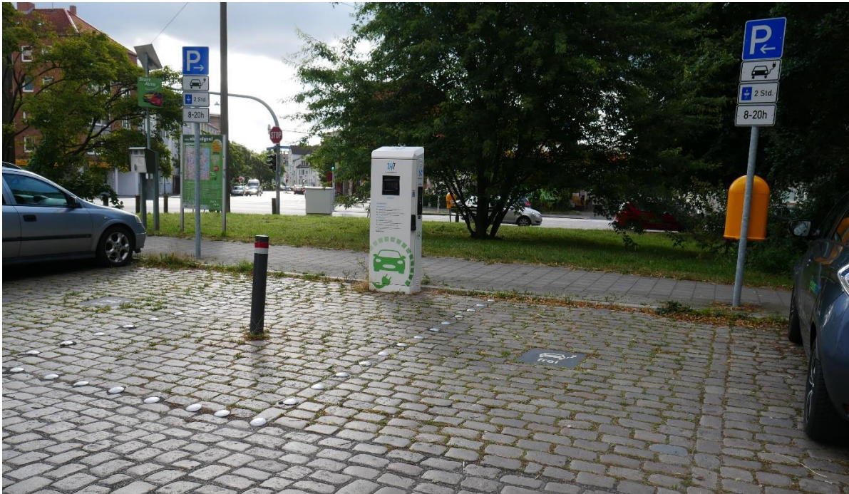
Abbildung 24: Barrierefreie Ladeinfrastruktur in der Stadt Kiel (Eigene Aufnahme)
